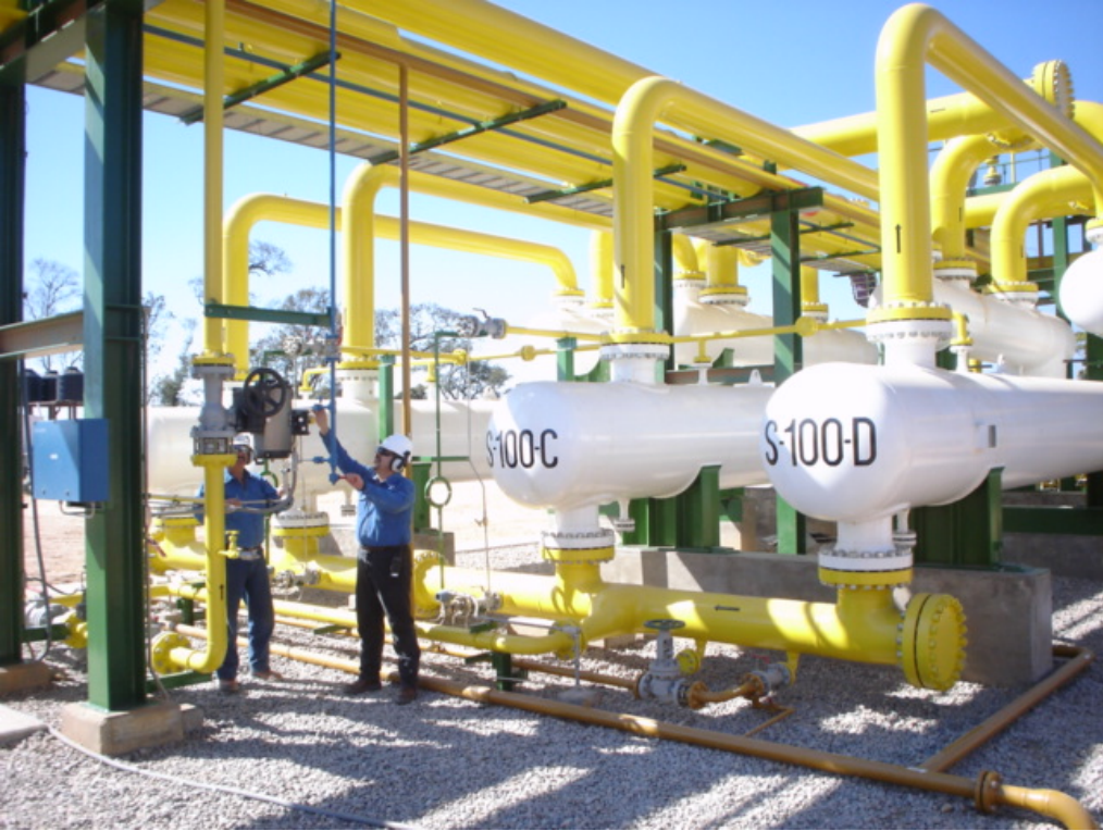
Figura 5 Slug-Catcher durante la etapa de operación
