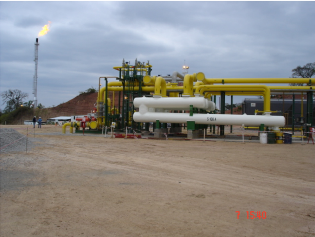
Figura 6 Slug-Catcher durante la etapa de operación
